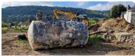
Cuve à dépolluer - Darnétal (76)
