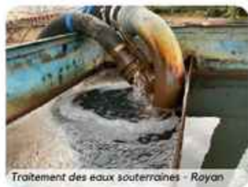
Traitement des eaux souterraines - Royan
