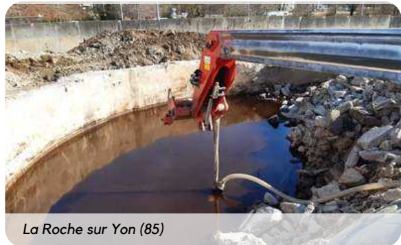
Cuve à dépolluer - Darnétal (76)
